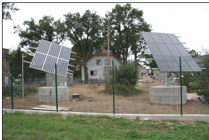
Rys. 2. Panele fotowoltaiczne zainstalowane w Ostoji (fot. P. Rogalska)
