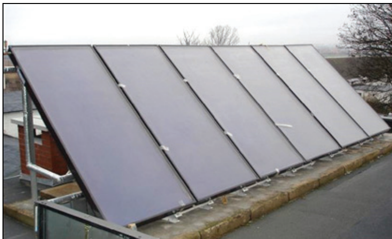
Rys. 1. Płaskie kolektory cieczowe zainstalowane na dachu Ośrodka Szkoleniowo-Badawczego w Ostoi (fot. P. Rogalska)
